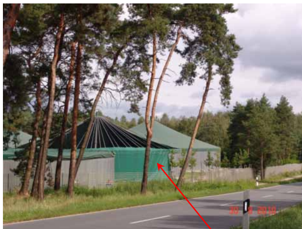
rechter Schadens-Silo (Ost-Mitte)– abgehobene einschalige HSD- PVC-Plane
