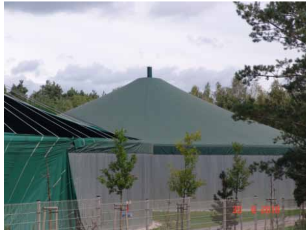
Dritter Silo der Standort-Reihe mit einem einschaligem HSD-PVC-Silo-Dach. Die Abdeckung dieses Silos zeigte keine Schäden.
