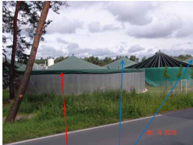
linker Schadens-Silo (Süd-Ost)– PVC-Planen-Abdeckung war vollständig eingebrochen. Die Mittelstütze war infolge der gerissenen Unterzug-Gurte umgefallen, im Hintergrund die unbeschädigten Silos ebenfalls mit einschaligem HSD-PVC-Dach.
