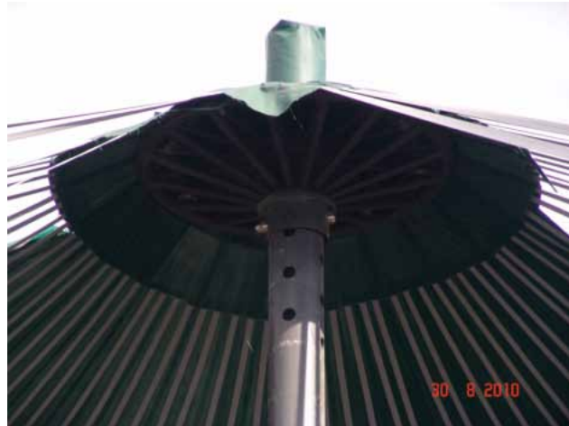
Mittleres Silo mit der verbliebenen Dachhälfte und der Risskante an der Stützenhaube
