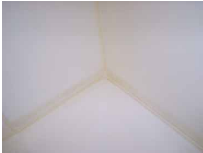
Eckverfugung – Fugenmaterial wurde zu dick aufgetragen.
