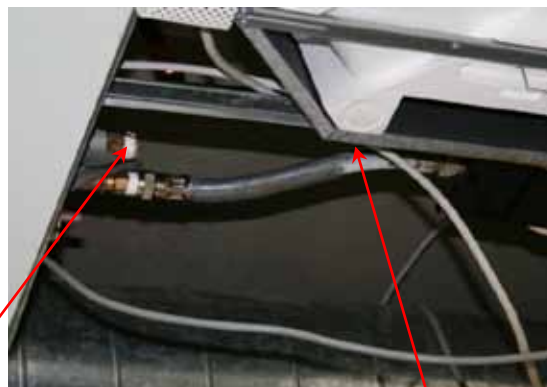
Der Schadensschlauch war ausgebaut, sichtbar der Parallelschlauch mit analoger Einbauweise
